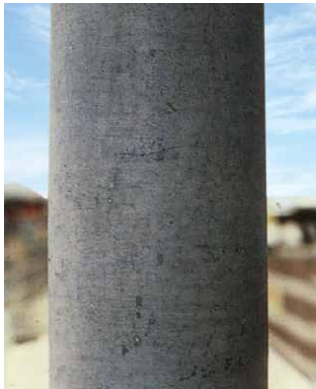
Kuva 10-1. Altistunut pinta, jossa sinkkipinnoitteen ulko-kerros on puhdasta sinkkiä. Kirkas pinta katoaa ja korvautuu harmailla korroosiotuotteilla, joita joskus kutsutaan sinkkipatinaksi.
