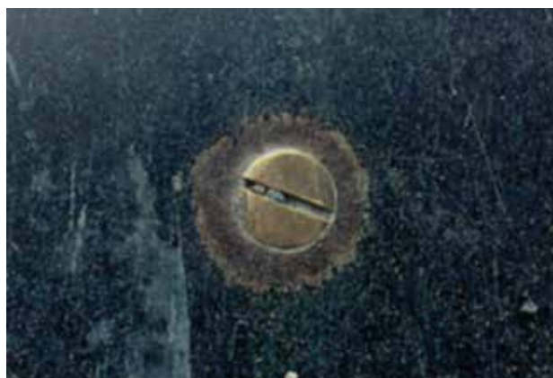
Kuva 10-13. Messinkiruuvi sinkityssä teräksessä syövyttää sinkkiä.
