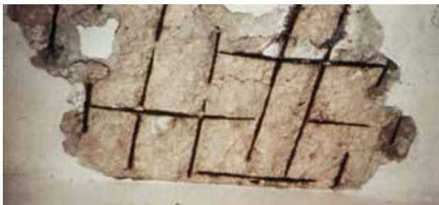
Kuva 10-14. Pintakerroksen irtoaminen raudoituksen yläpuolelta betoniteräksen korroosion vuoksi.
