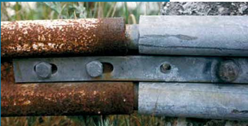
Kuva 1-2. Vasemmalla kuvassa ruostunut maalattu tiekaide. Vertaa oikealla puolella olevaan kuumasinkittyyn kaiteeseen.
