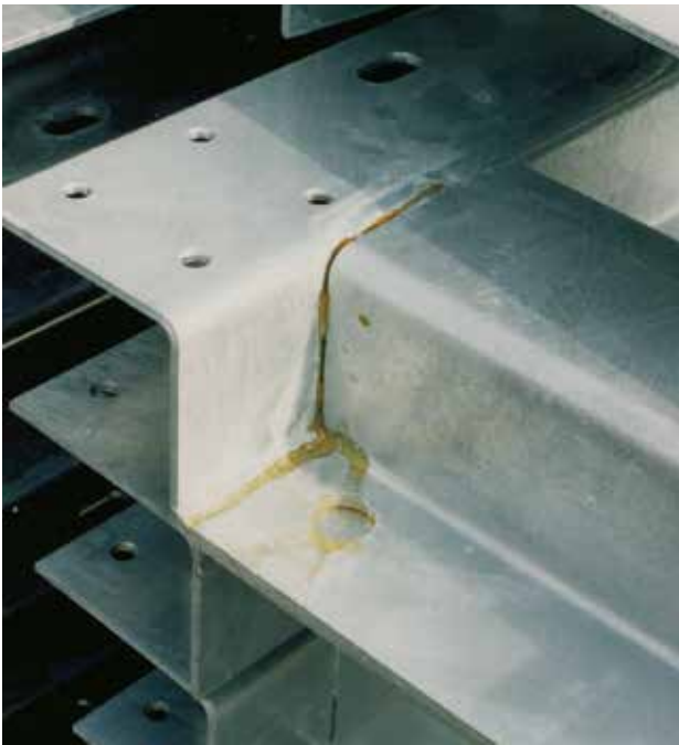
Kuva 7-11. Happopesäke, josta happo ja raudan suolat ovat syövyttäneet reiän sinkkikerrokseen aiheuttaen värivirheen.
