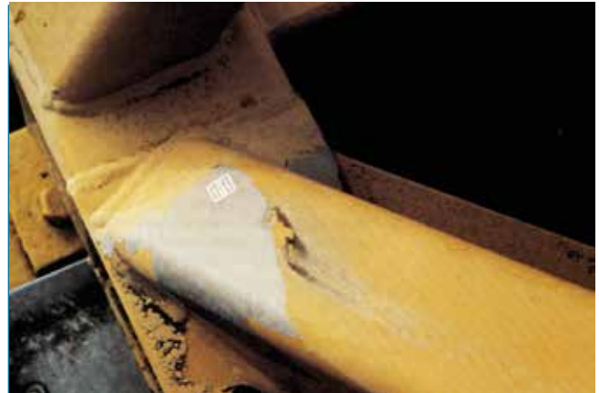
Kuva 11-3. Tarkista aina maalivalmistajalta, että pohja- ja pintamaalisopivat yhteen. Tässä tapauksessa hilseily johtuu keltaisen, korkeakiiltoisen alkydimaalin yhdistämisestä harmaaseen, kumiperustaiseen pohjamaaliin (22).
